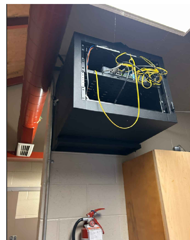
3 E2.0.0 EXISTING DATA RACK SCALE: N.T.S.
